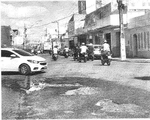
Fendas geram enormes poças d'água, dificultando a vida dos condutores e atrapalhando o trânsito.
