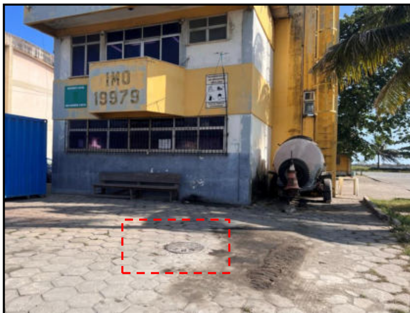
Foto 54: Localização, destacada pela poligonal em vermelha, da fossa séptica existente no prédio do SETOPE. Fonte: Ensima, 2022.
